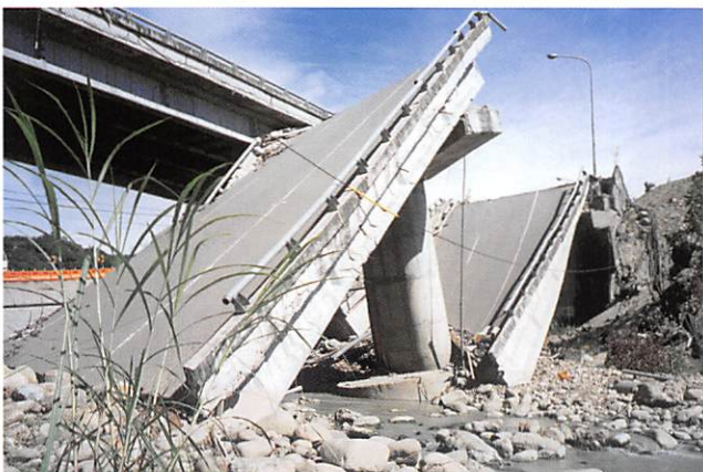
写真-1 石圍橋の桁落下
