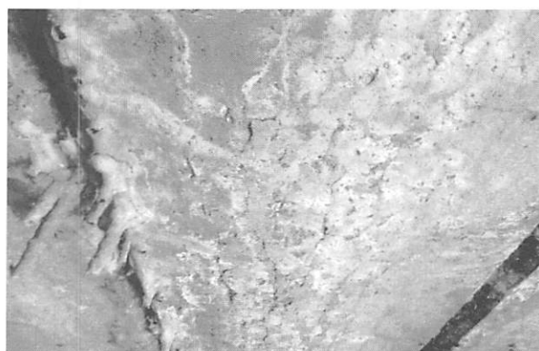
主桁ひびわれ
