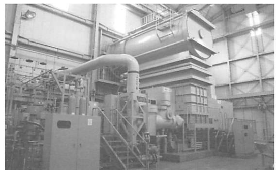
山川発電所 蒸気タービンおよび発電機
