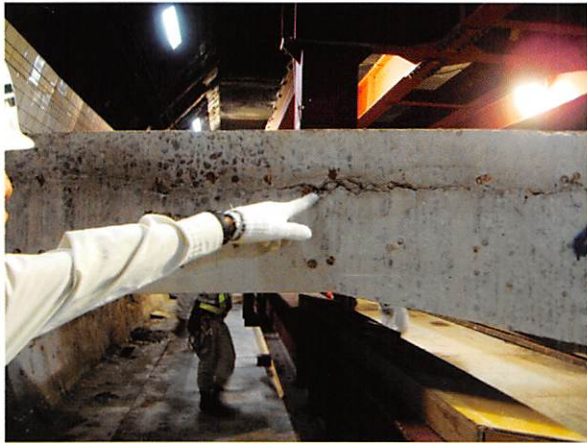
写真-2 撤去床版の損傷状況
