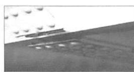
写真-7 下フランジ部の腐食状況
