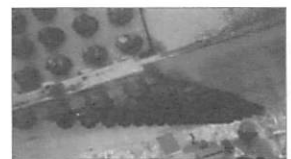
写真-2 現場継手部の腐食状況
