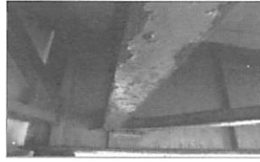
写真-3 部材エッジ部の腐食
