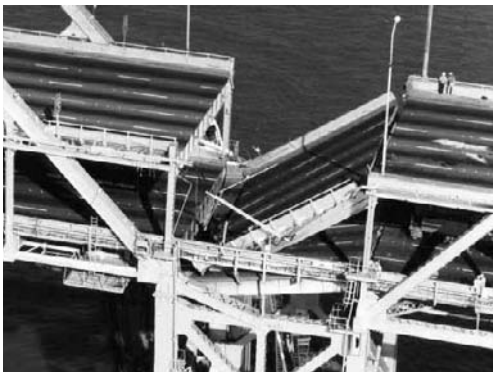
図-12 地震時、落下したベイブリッジ
