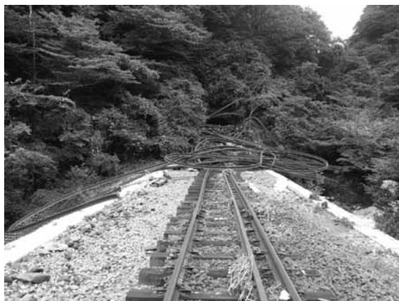
写真-4 トンネルからのレール流出状況
