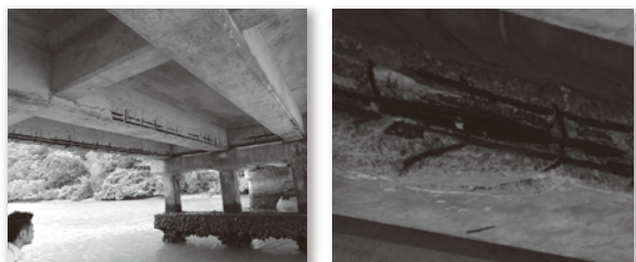
写真-1 塩害劣化事例(左 RC上部工、右 PC上部工)
