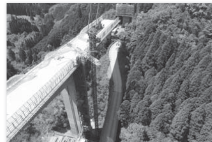
写真-5 地震により倒壊したタワークレーン
