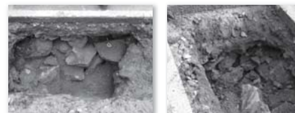
写真-1 朝地橋の裏込め部の壁石背面部(左)と路床部(右)
