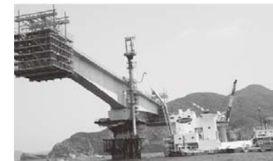
写真-2 コンクリートミキサー船を使用したコンクリート打設状況
