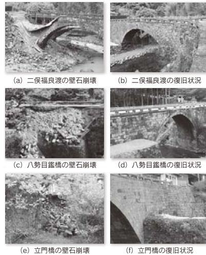
写真-6 石橋の地震被害と復旧状況
