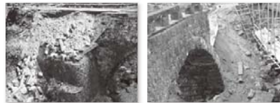
写真-1 地震による石橋の壁石被害状況
