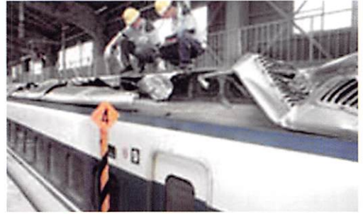
新幹線のトンネル壁落下事故
