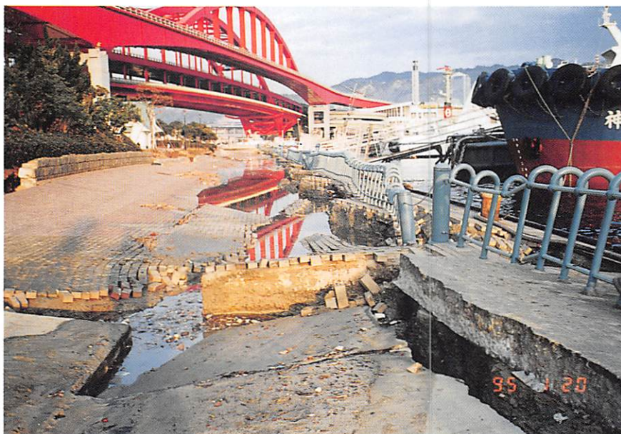
ポートピアランド北公園岸壁の被害
