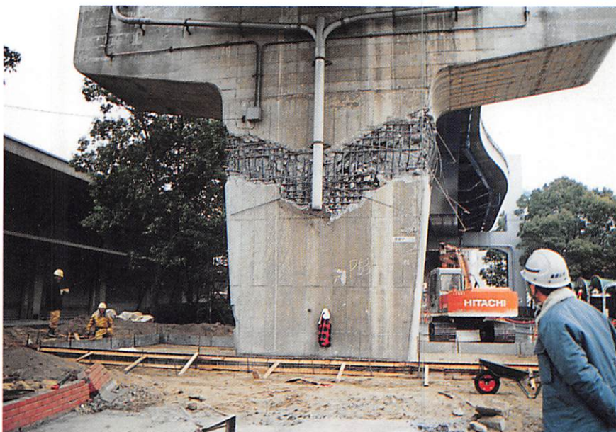
鉄筋コンクリート橋脚の破壊状況
