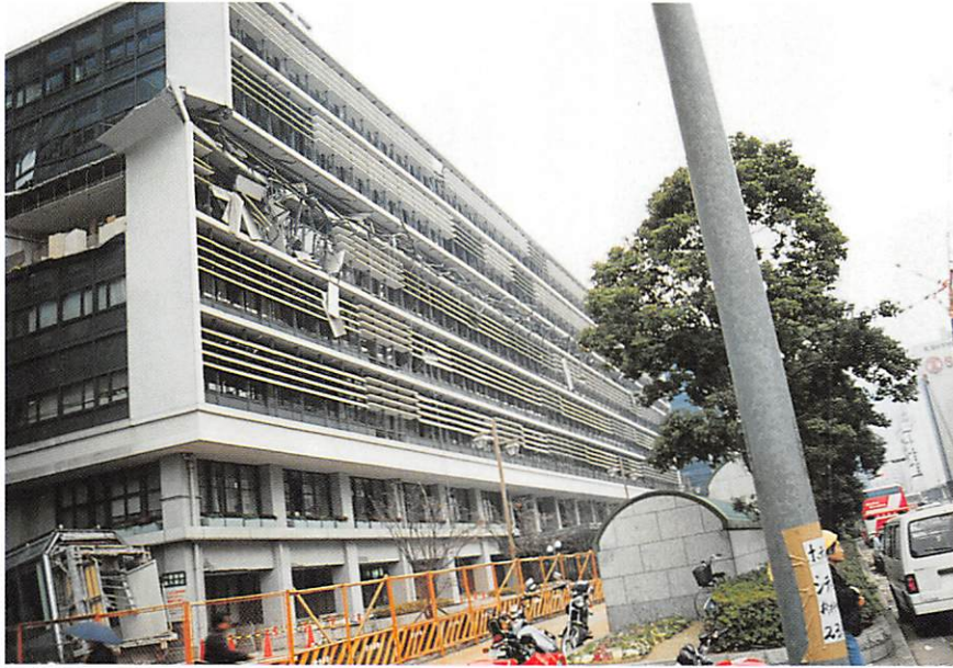
神戸市役所中間階の崩壊
