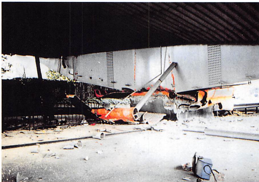
完全に座屈圧壊した鋼橋脚
