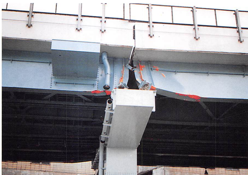
鋼桁支承部の破壊
