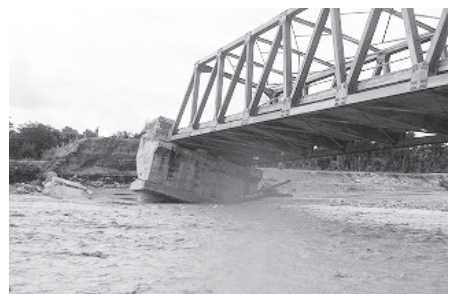
写真-33 アイアサ橋 (落橋後)
