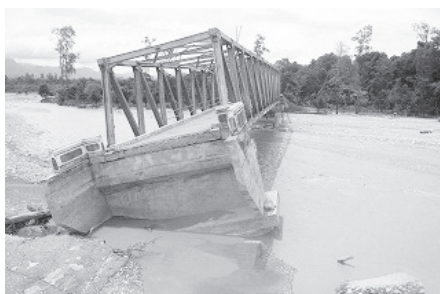
写真-32 アイアサ橋 (落橋後)
