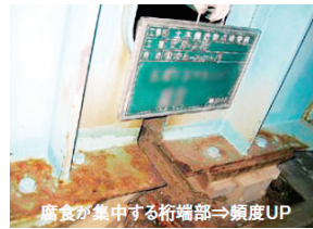
図-5 桁端部腐食
