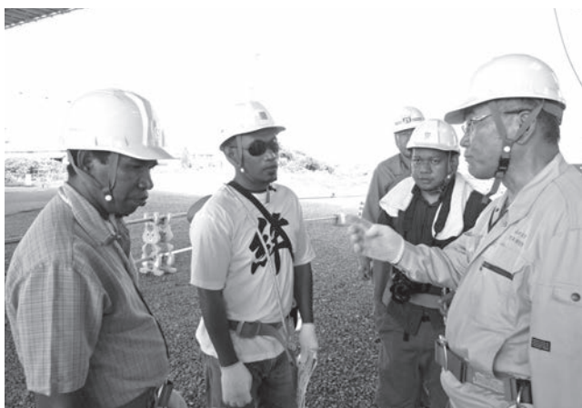
写真-6 博士前期課程の同僚2名との橋梁架設現場訪問による技術研修風景（左端がMr. Aeixo）
