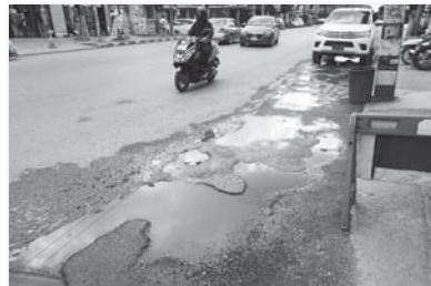
写真-5 排水設備が不十分な車歩道境界部
