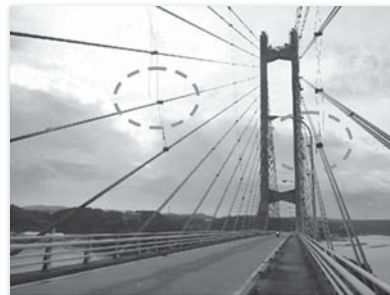
写真-1 制振ワイヤ破断状況
