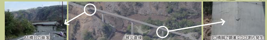
A1橋台の崩落
