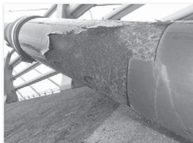
写真-3 斜材ケーブル定着部付近の損傷
