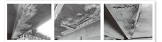
写真-2 主桁下面の損傷状況
