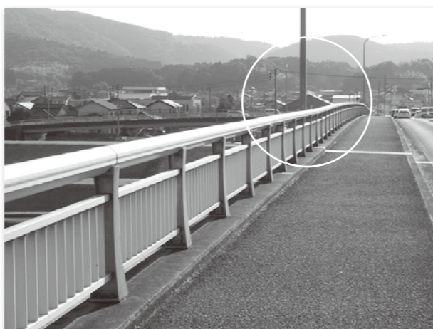
写真-2 ヒンジ部の垂れ下がり
