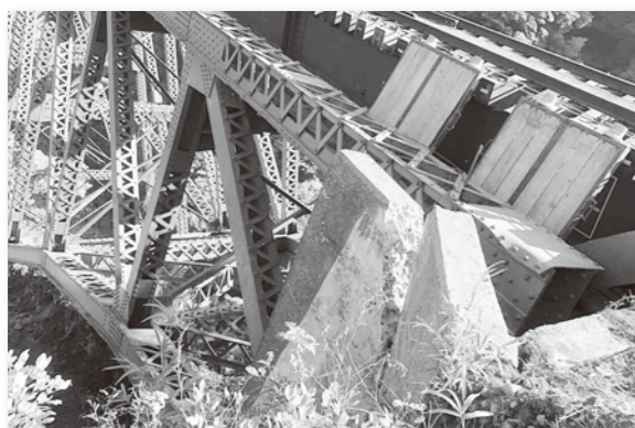
写真-9 白川橋梁(橋台部のひび割れ)
