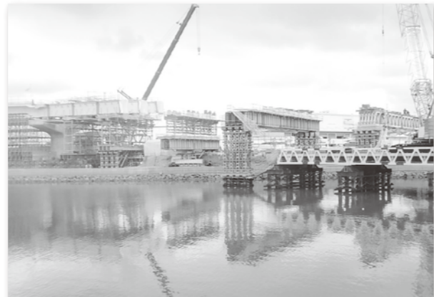
図-9 ベント設備全景
