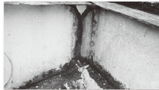
写真-6 P2付近側縦桁腐食状況
