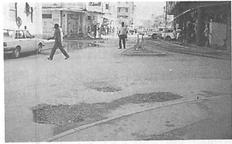
劣悪な市中心部の道路
